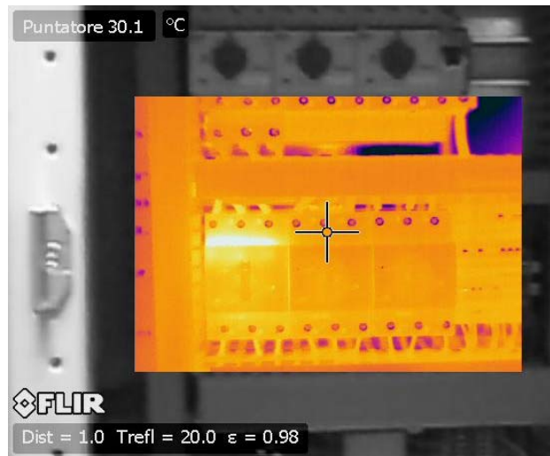
Monitoraggio quadro elettrico MT
