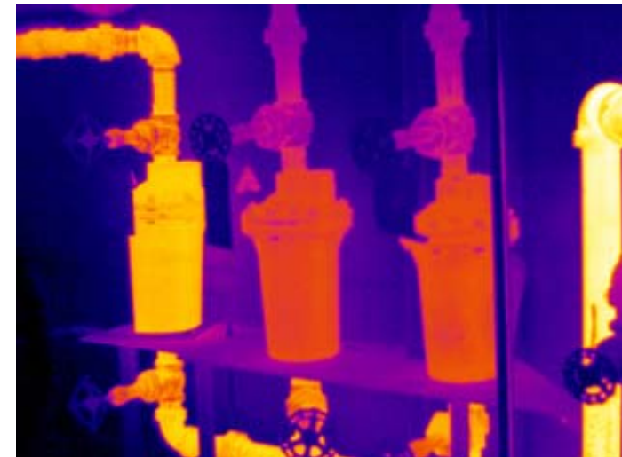
Perdita da uno scaricatore di condensa di un impianto a vapore
